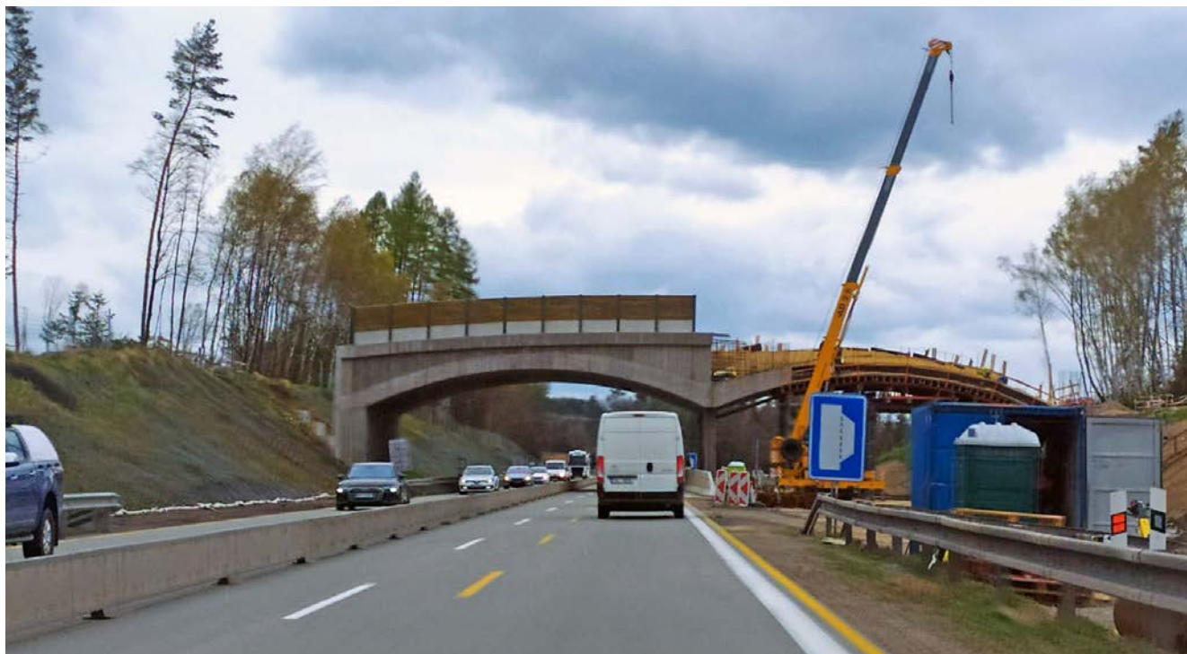
Obr. 9: Zelený most budovaný na migračním koridoru na dálnici D1 v úseku mezi Jihlavou a Měřínem. Dálnice D1 je v úseku přes Českomoravskou vysočinu zcela neprůchodná pro velké savce. Čtyři nové ekodukty by měly tuto situaci výrazně zlepšit.
